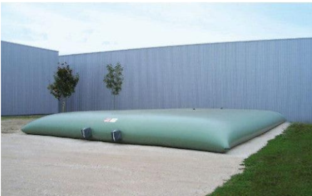
Exemple de réserve incendie prévue sur le site (bâche souple)
