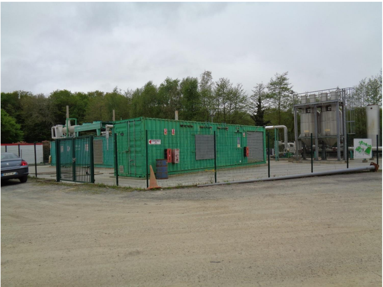
Installation de valorisation de biogaz
